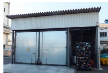
溶融固化施設
